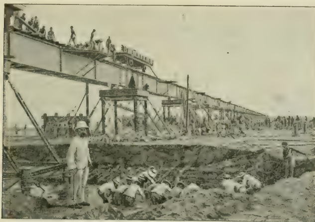
SUR LE HOUANG-HO (FLEUVE JAUNE) CONSTRUCTION D'UN PONT DE 3 KILOMÈTRES PAR LES INGÉNIEURS FRANÇAIS DE LA LIGNE FRANCO-BELGE.
